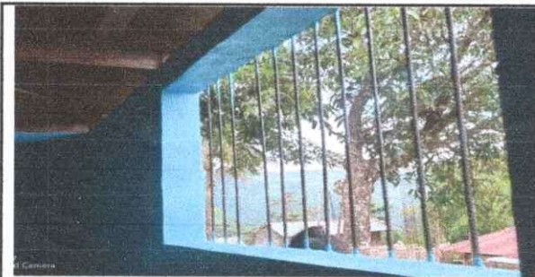
Foto 5: Fabricación de ventana de metal con marco de angular de 1 pulgada, con vidrios transparente.
