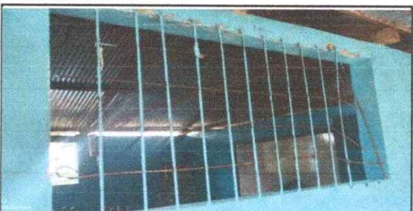
Foto 6: Fabricación de ventana de metal con marco de angular de 1 pulgada, con vidrios transparente.
